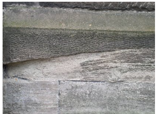
Lagerförmige Rückwitterung im Sockelbereich (ohne Maßstab)
