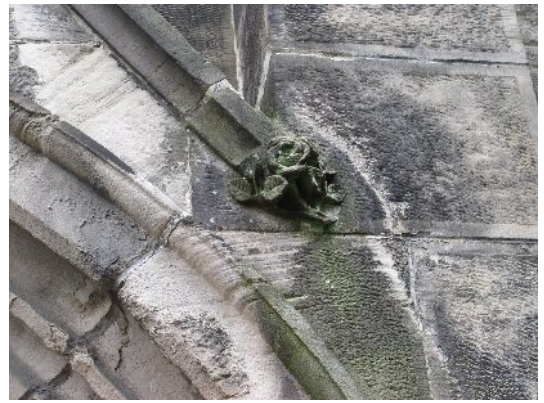
Lagerförmige Rückwitterung am Portal (ohne Maßstab)
